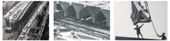
図2：当時の施工現場の様子。基壇上でプレキャストされ、躯体に積層していく。
